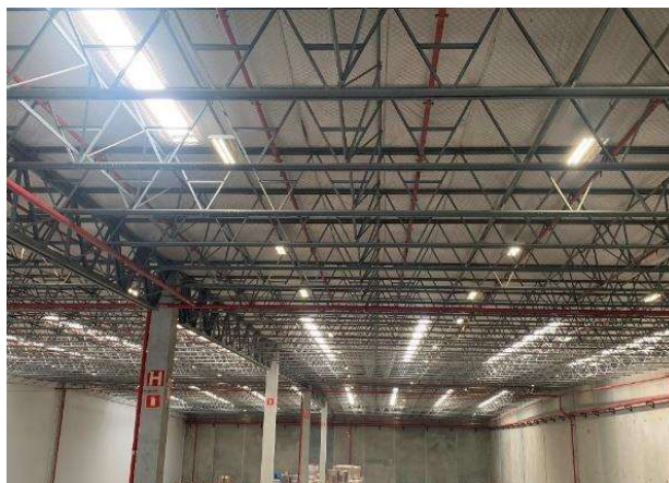
Figura 9: Sprincker - Área de Armazenagem
