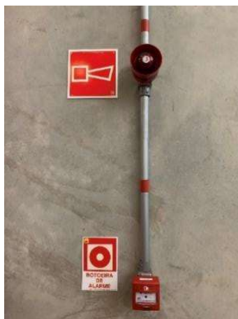
Figura 12: Alarme de incêndio
