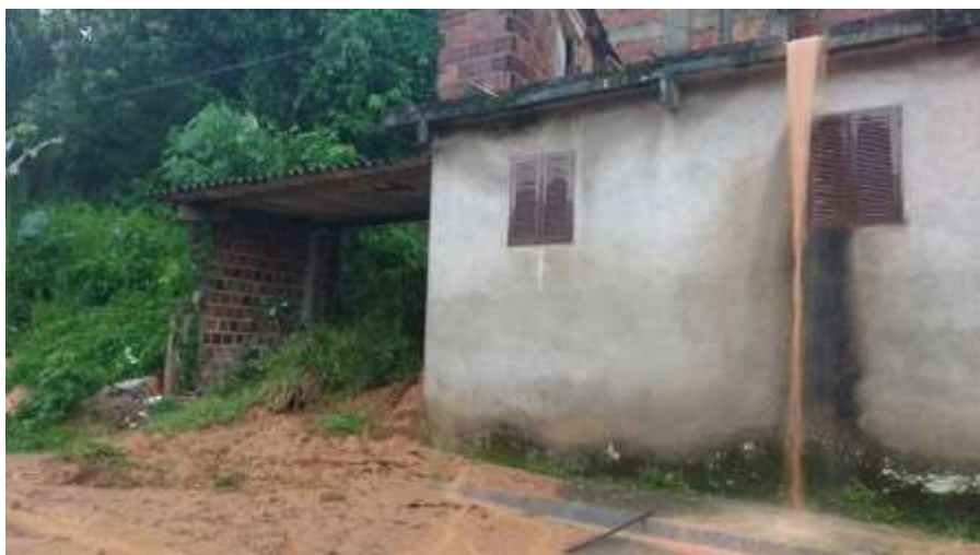
Figura 3 Edificação em área interdita - Fonte: Arquivo da Defesa Civil de Angra dos Reis
