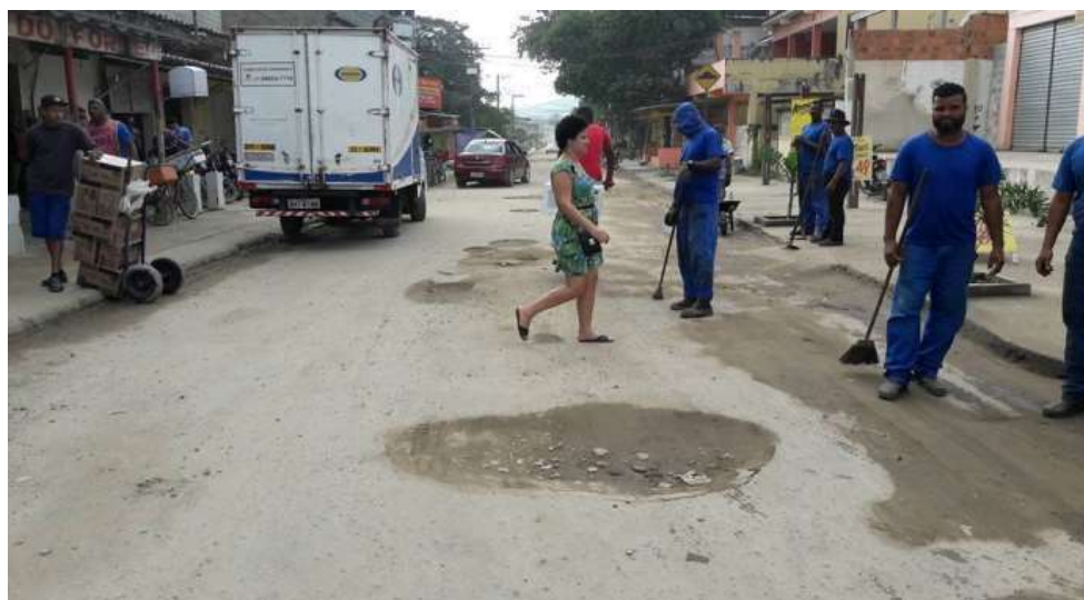
Figura 8: avarias encontrado na via Fonte: (Autor, 2018)
