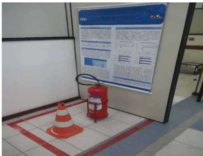
Figura 12 Extintor Fonte: Autora (2018).
