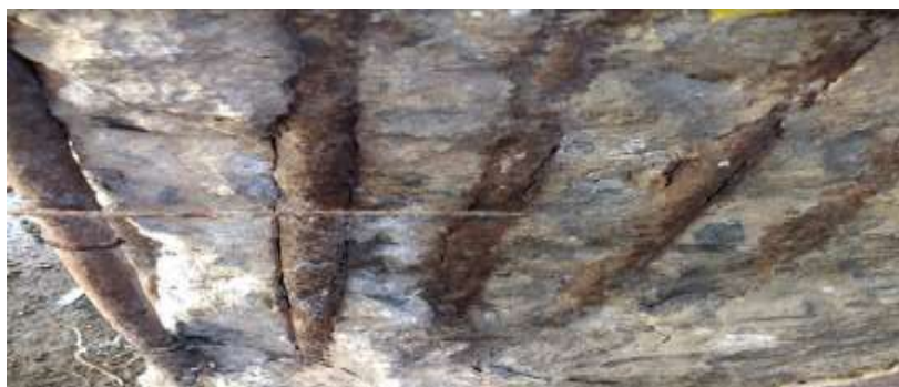
Figura 4: Carbonatação nos pilares do viaduto.
