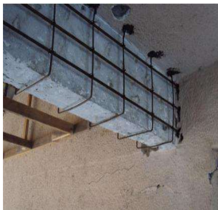
Figura 3 - Aumento da viga na face superior.
