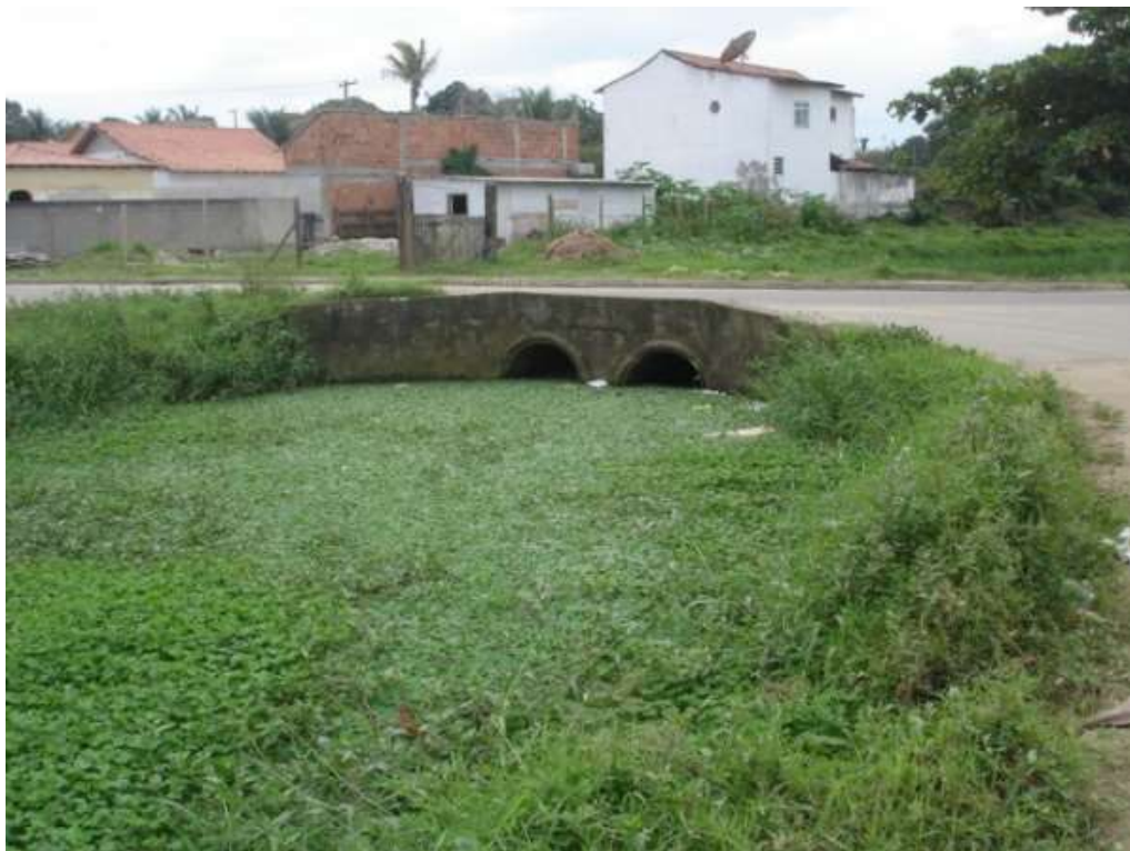
FIGURA 8: Canalização parcialmente comprometida pela presença de plantas aquáticas.
