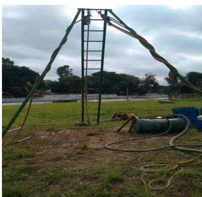
Figura 5 – Tripé. Fonte: OMG Serviços de Fundação, 2018.
