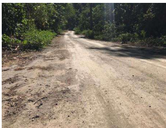
Figura 3 – Trecho da estrada após intervenção da Prefeitura Municipal de Nova Iguaçu (Fonte: O autor, 2019).
