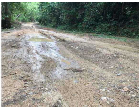
Figura 1 – Trecho da Estrada da Cachoeira (Fonte: O autor, 2019).
