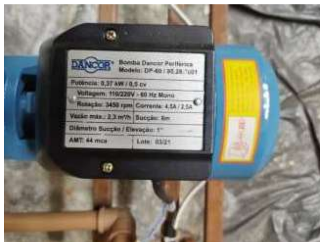
Figura 4 – Placa de especificações da bomba.
