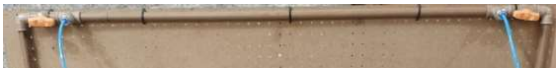
Figura 6 – Tubulação reta de PVC de \frac{1}{2} ".
