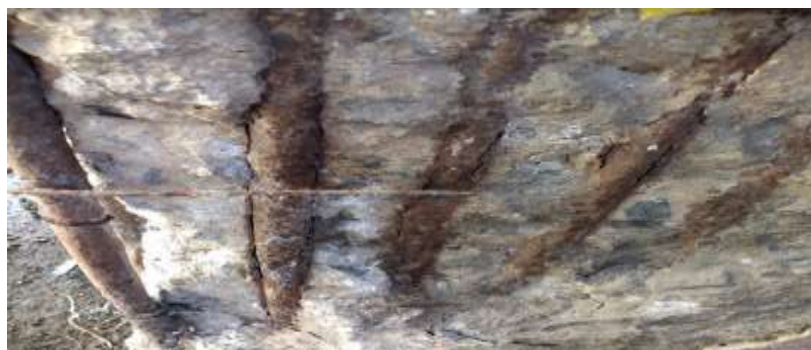
Figura 4: Carbonatação nos pilares do viaduto.
