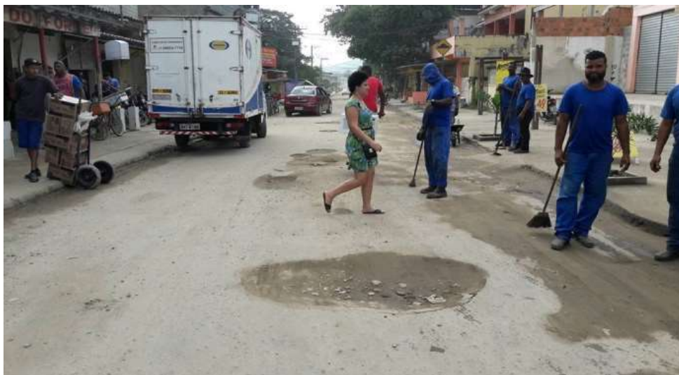
Figura 8: avarias encontrado na via Fonte: (Autor, 2018)
