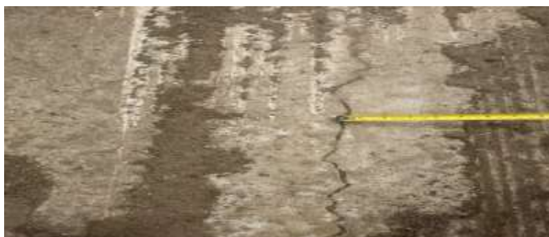
Figura 3: Fissura na parte superior do vão central do Viaduto.
