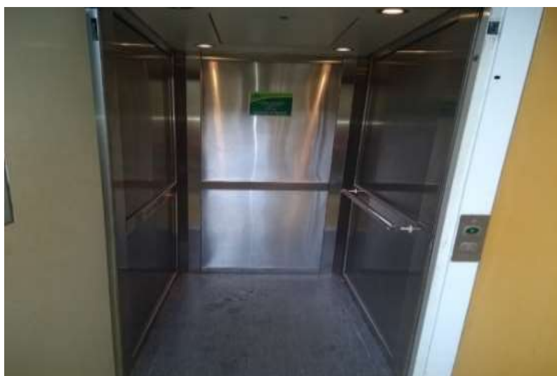
Figura 8 Interior do elevador de acessibilidade Fonte: Autora (2018)
